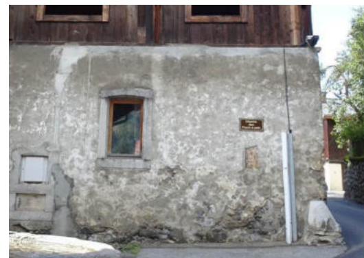
Le coffret pourrait être mieux intégré dans la façade
