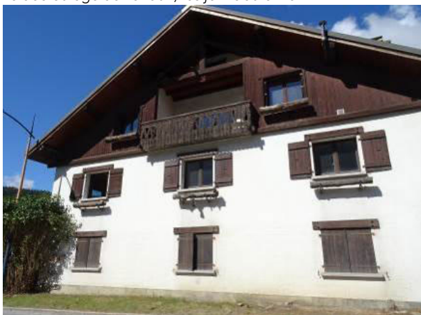
Les enduits trop raides Ouvertures de dimension standard, faux linteaux bois
