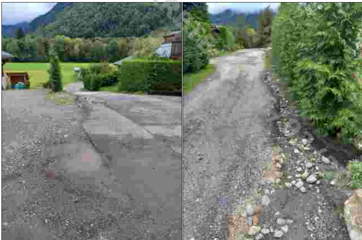
Absence d’éléments de collecte des EP et ravinement – Impasse de Sous les Bourres
