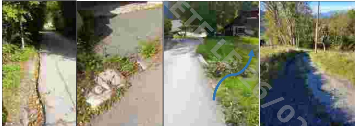
Affaissement de la chaussée, grille obstruée, risque de ruissellements, ravinement du chemin – Route de Bosna
