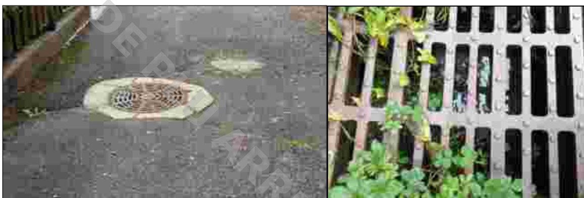
Grille légèrement surélevée par rapport à la chaussée et grille obstruée
