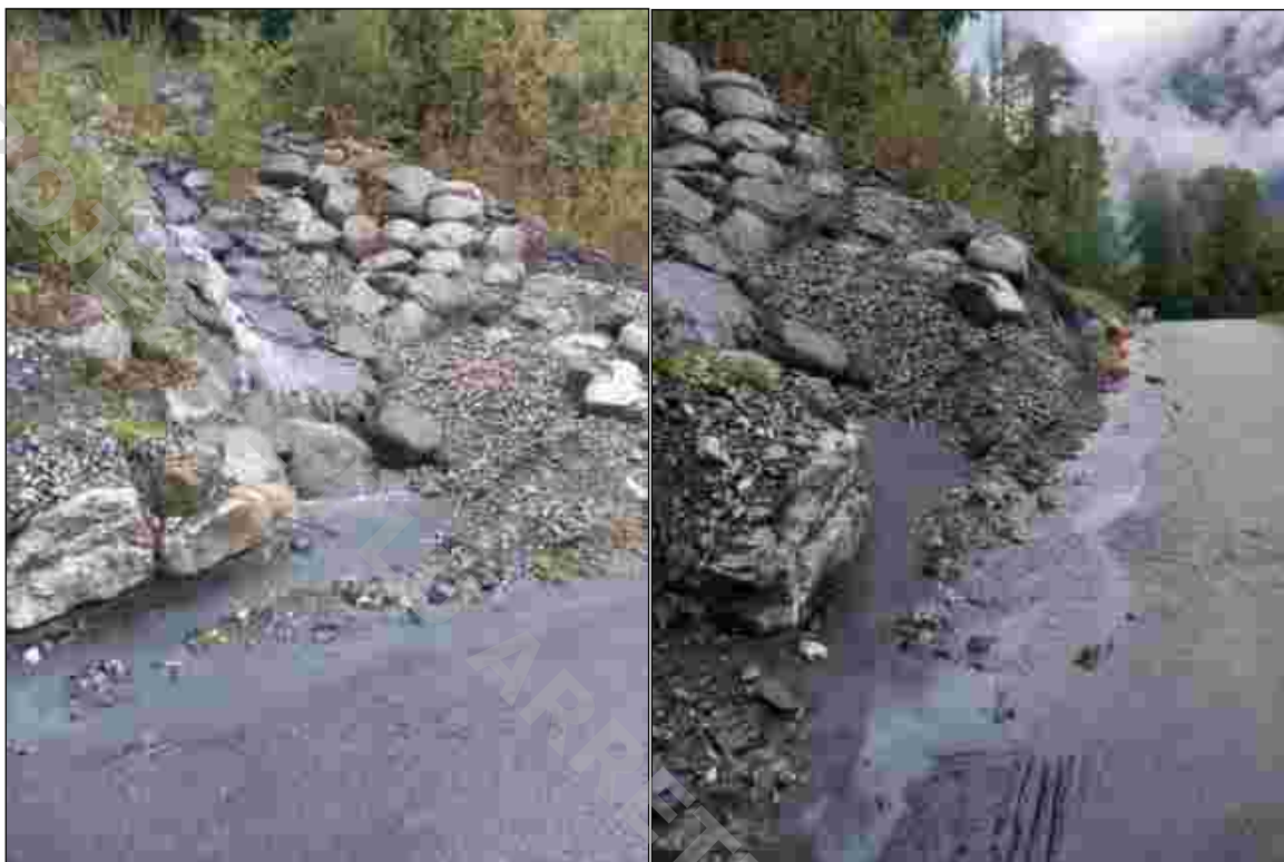
Obstruction d'un ouvrage de franchissement d'un ruisseau et débordement sur la RD143
