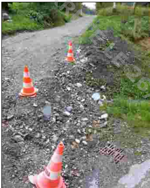
Dépôt généré par le ravinement d'un chemin
