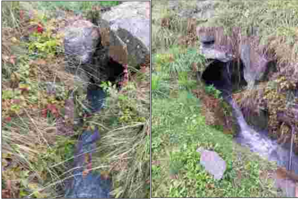
Obstruction du busage Ø500 du ruisseau de la Planchette et Ø1100 aval
