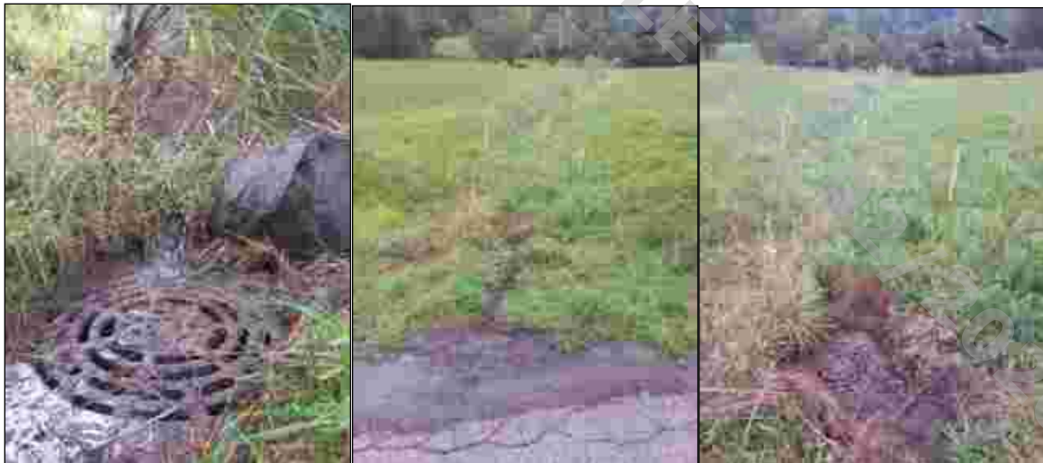
Engouffrements de deux thalwegs dans des grilles EP obstruées
